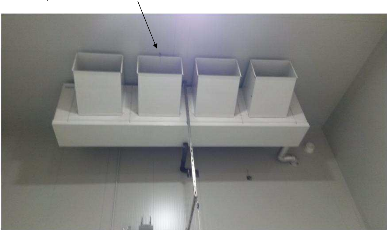
Foto 1: uscita del condotto dell'ozono all'interno della cella
